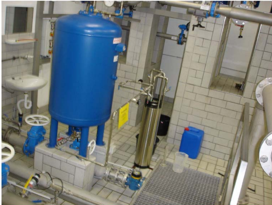
Abb. 21. Halbtechnische Versuchsanlage (Edelstahlbehälter Bildmitte)
