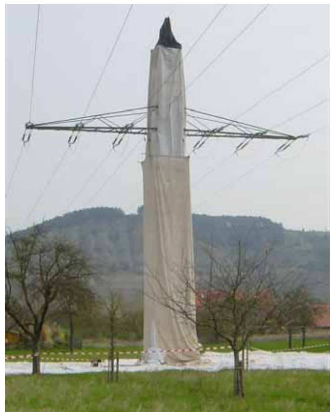
Bild 1: Teilweise mit Folien eingehauster Hochspannungsmast
