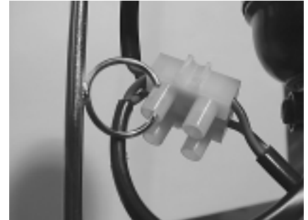
Abb. 15 Fehlerhafte Befestigung der Lüsterklemme
